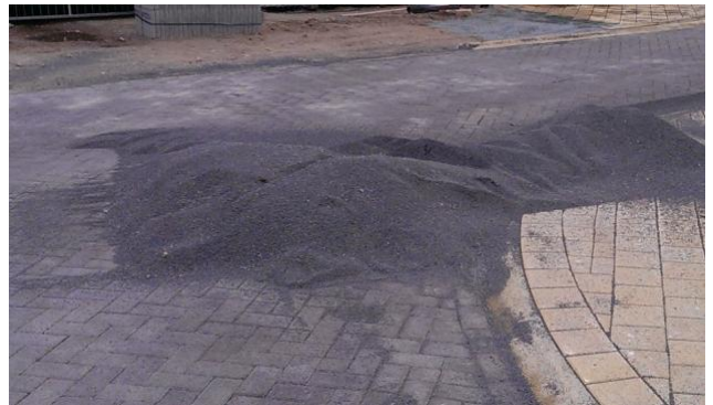
Figuur 31: Split op de verharding
