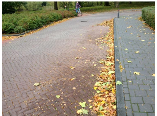
Figuur 9: Vervuiling van de verharding door bladval
